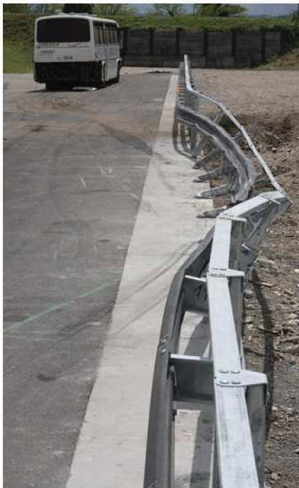
Dégâts du dispositif
