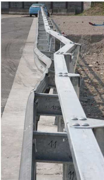
Dégâts du dispositif
