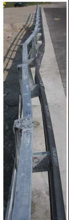
Danni sul dispositivo
